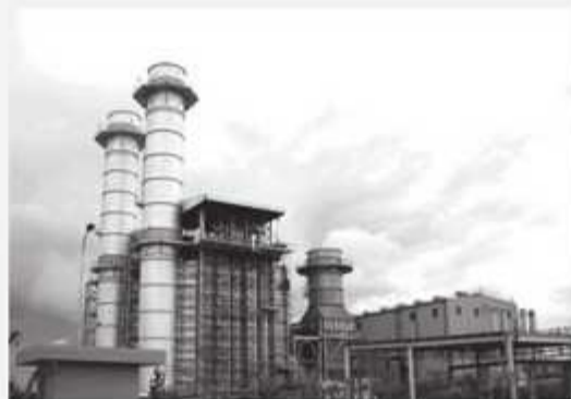
Nhà máy điện Nhon Trạch 1
